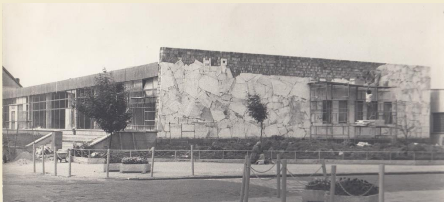
1975 r., pawilon meblowo-elektryczny w trakcie wykładania bocznej ściany kamieniami z Gór Świętokrzyskich
